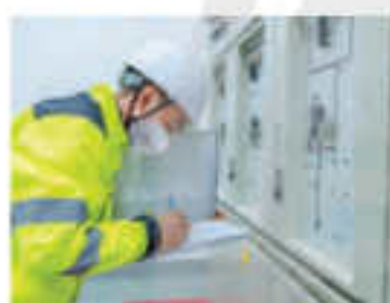
a) Vận hành hệ thống điện
