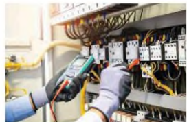
c) Bảo trì thiết bị điện
