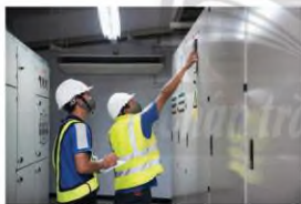
a) Vận hành hệ thống điện
