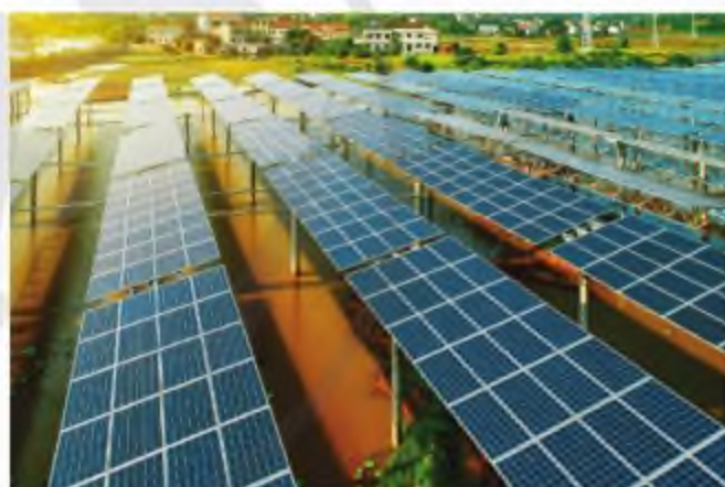
Hình 12.4. Nhà máy điện mặt trời
