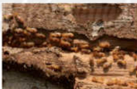
Mối phá hoại công trình xây dựng
