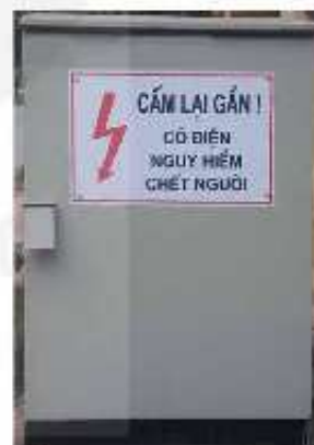
Hình 17.7. Biển cảnh báo an toàn điện
