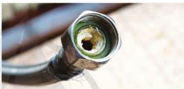
Hình 19.1. Một đoạn ống nước bị đóng cặn
