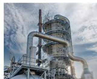
▲ Cột chưng cất phân đoạn hoá dầu
